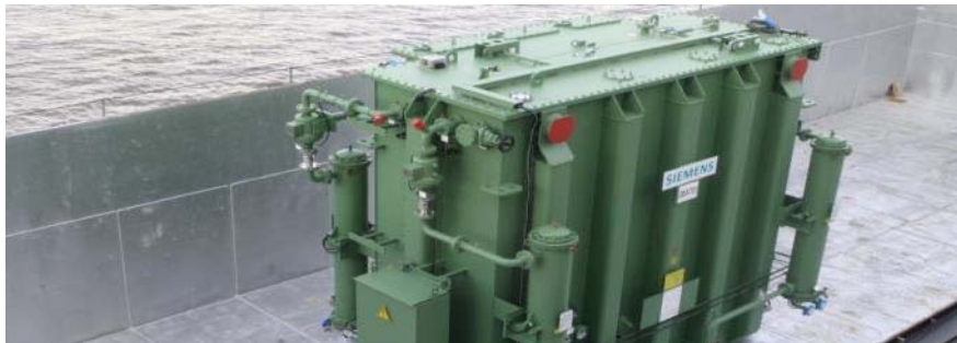
NEUER Maschinentransformator Anlieferung
